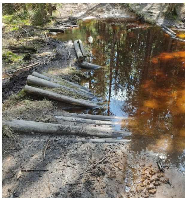
Фото 11. Заболотившийся пониженный участок с разрушенным бревенчатым настилом [фото авторов]
