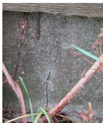
Фото 3. Трещины и выбоины по фундаменту Photo 3. Cracks and potholes on the foundation
