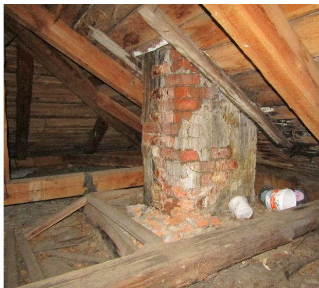
Фото 8. Деструкция кирпичной кладки печных труб
