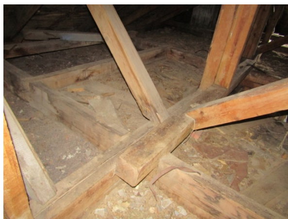
Фото 10. Следы протечек по элементам стропильной системы, поражение гнилью и разрушение элементов
