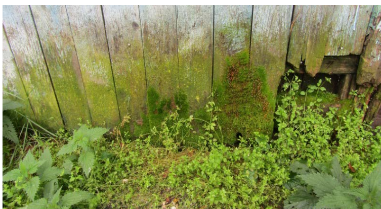
Фото 4. Биоповреждение цоколя. Поражение гнилью обшивки наружных стен здания
