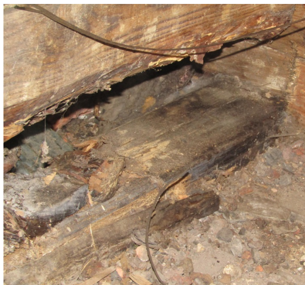
Фото 6. Поражение гнилью и разрушение элементов
