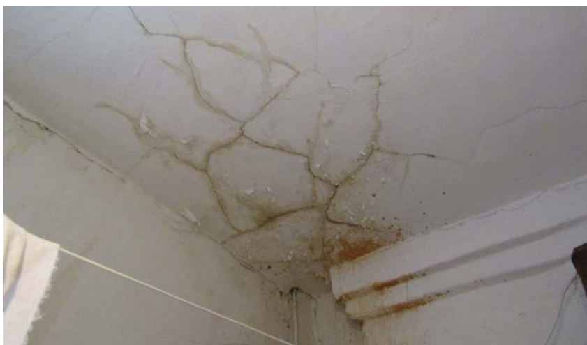
Фото 9. Трещины по перекрытиям и стенам, отслоение штукатурки. Следы протечки
