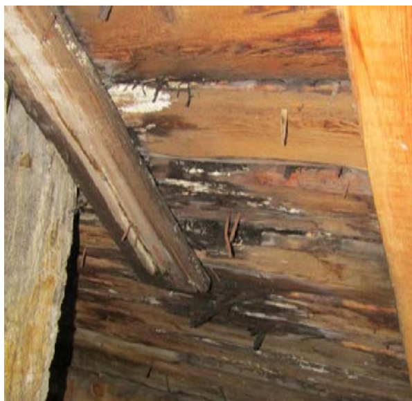
Фото 5. Следы протечек кровли по элементам стропильной системы
