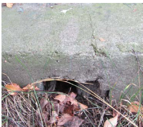
Фото 2. Продухи на уровне земли Photo 2. Destruction at ground level
